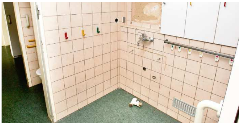
Die Waschbecken sind weg, die Leitungen verkeimt.
